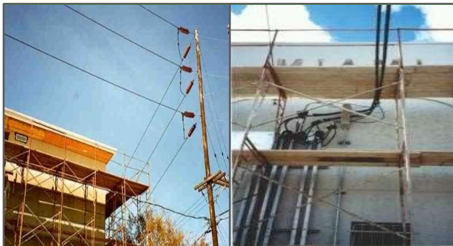
شکل ۱- نمونه هایی از نصب غیر ایمن داربست در کنار خطوط برق
